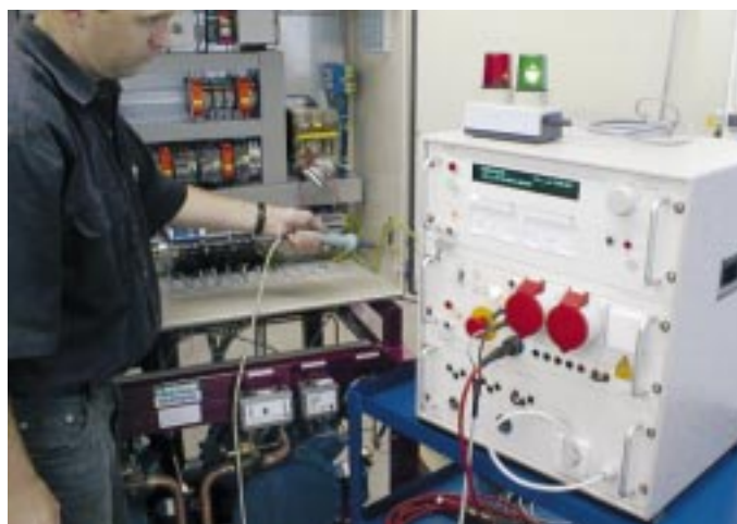
Durchführung eines Schutzleitertests
