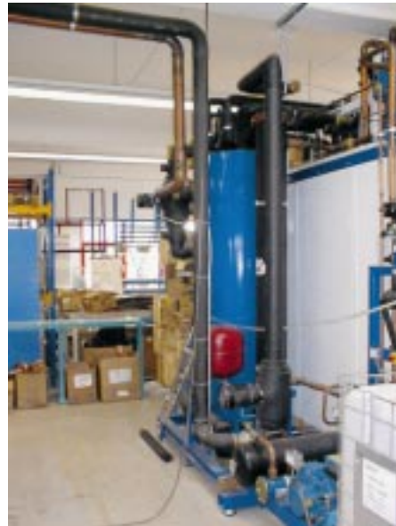
Kälte- und Kondensatorleistung werden in einem gemeinsamen Solebehälter gegeneinander kompensiert
