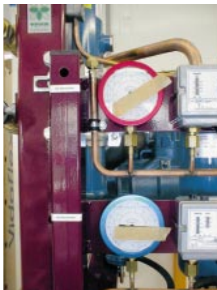
Abkleben des Prüfmanometers mittels Klebeband läßt keine verbindliche Aussage auf den Dichtheitsgrad einer Kälteanlage zu
