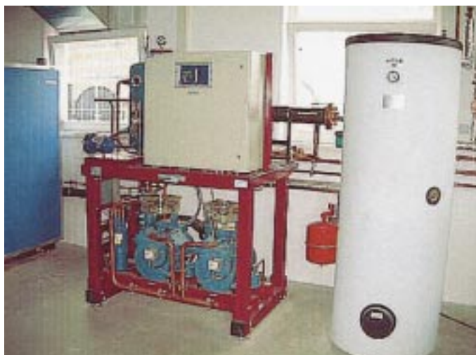
Die Kälteanlage im neuen Expo-Minimal-Markt in Hannover
