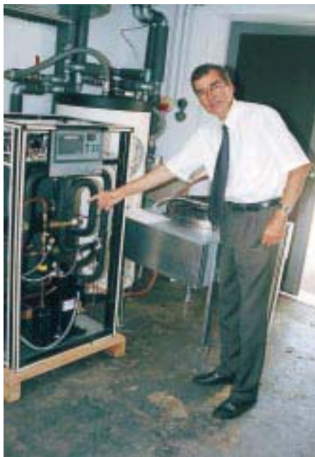
Direktexpansion ist bei Ochsner auch mit der Wärmequelle Luft gegeben. Diese Split-Wärmepumpe hier im Versuchsraum eignet sich sowohl für die Fußbodenbeheizung als auch im Sommer für das Kühlen
