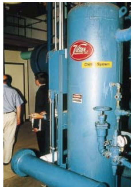
Ammoniak wird auch in den USA für Kaltwassersätze in Klimaanlagen eingesetzt. So bei den St. Paul Stadtwerken und bei General Mills – zwei der sehr interessanten technischen Besichtigungen
