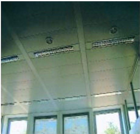
Kühldecke in einem Bürogebäude
