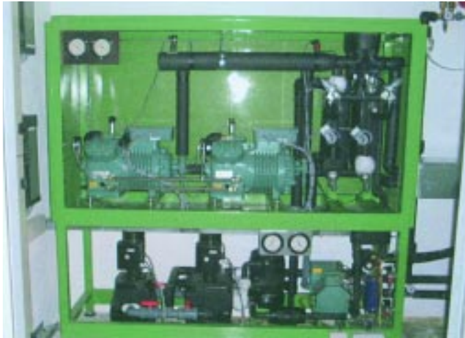
Die komplette Kälteanlage mit der Propananlage oben und der CO 2 -Anlage unten
