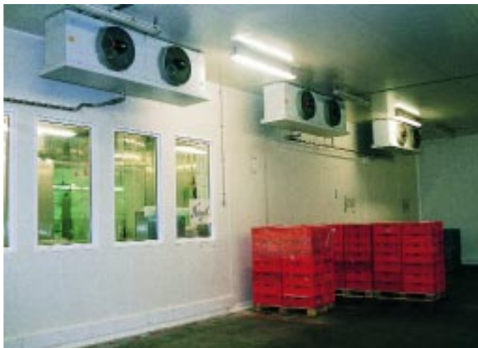
PEP-Verdampfer (Fabrikat Küba) im Versandraum eines fleischverarbeitenden Betriebs in Nürnberg
