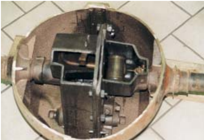
Bild 6 Blick in die Verflüssigerkugel mit Ölabscheider und Schwimmerkörper
