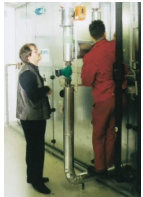
Am Klimablock für die Versorgung eines Kinosalles werden auf Veranlassung von Bernhard Hagen die Komponenten überprüft
