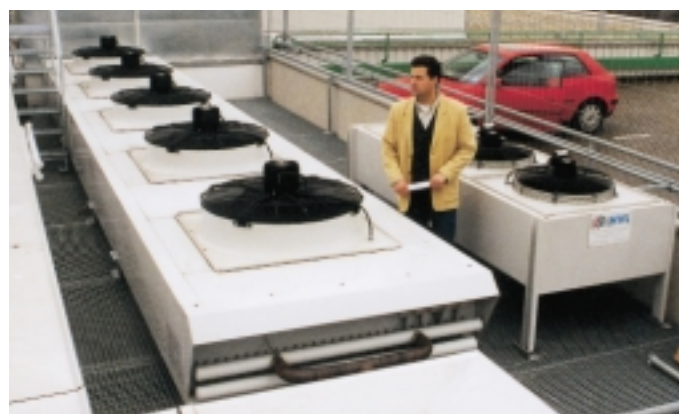
Udo Lehnerts bei der Inspektion der Verflüssiger auf dem Kinodach, rechts hinter ihm die Glykolkühler für die freie Kühlung
