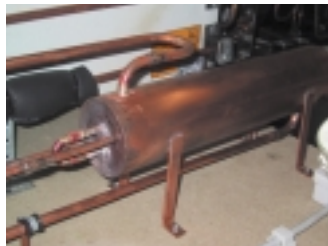
Für die Anfertigung dieses Flüssigkeits-Saugdampf-Wärmeübertragers als Arbeitsprobe war viel handwerkliches Geschick erforderlich
