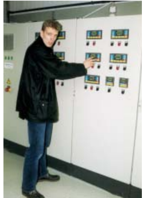
Michael Eckert erläutert das Handling unterschiedlicher Schaltschrankfunktionen
