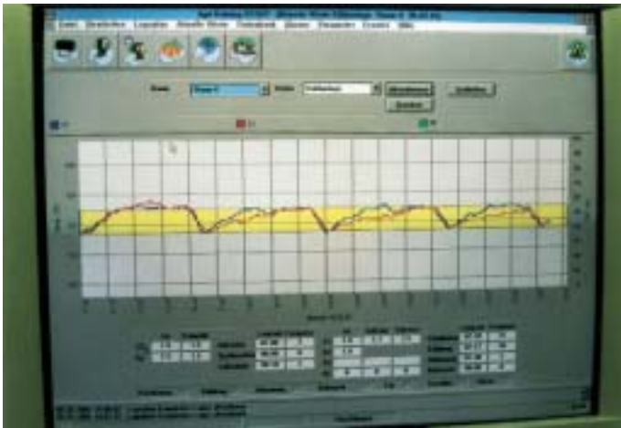
Raum 4: Einwandfreie Temperaturführung durch den Solewärmetauscher. Sie liegt im Mittel zwischen 1,7 °C und 2,5 °C
