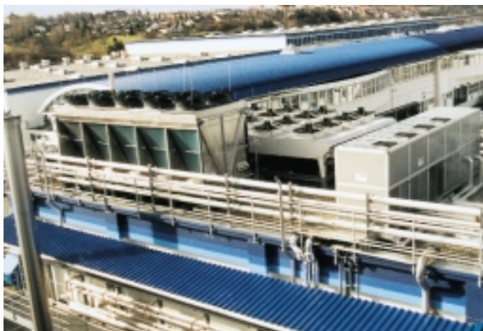
Auf dem Dach des neuen Werks 5 befinden sich die neuen Hybridkühler und die Freikühler (wovon hier ein Teil zu sehen ist) sowie die Zentrale der bereits vorhandenen Kälteanlage
