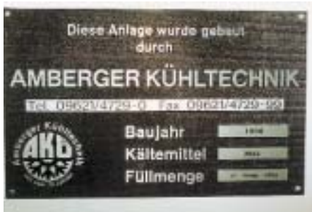
Hier steht's geschrieben: 1998 von der Amberger Kühltechnik installiert. Binäreiserzeugung mit zwei NH 3 -Kältemittelkreisläufen über Plattenwärmetauscher, Kältemittelfüllmenge jeweils 240 kg R 717
