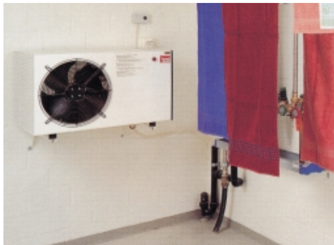
Ein Kondensationstrockner, hier in einem Wäscheraum, verbraucht nur 0,3 kW/kg Wäsche gegenüber 0,7 kW/kg bei herkömmlichen Trocknern modernster Bauart
