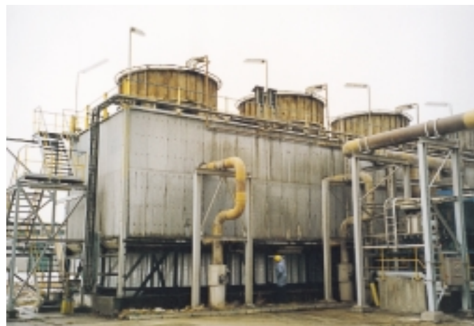
. . . in einem Kühlturmfeld der Firma Ausimont in Bitterfeld
