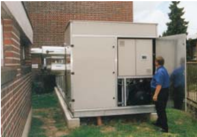
Bei geöffneter Tür gut zu erkennen: Der Schaltschrank mit dem Touchscreen zur Bedienung der Anlage
