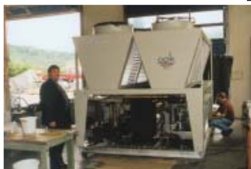
Ob Kaltwassersatz, hier zu sehen mit einer Kälteleistung von 245 kW zur Glykohlkühlung auf konstante 6 °C, ...
