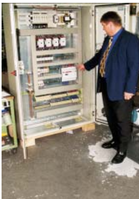
Das Herz jeder Kälteanlage: Der Schaltschrank mit dem Controller für die Verarbeitung aller Signale
