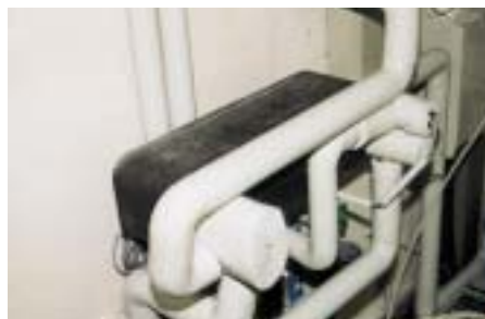
Der Wärmeübertrager für die Brauchwassererwärmung
