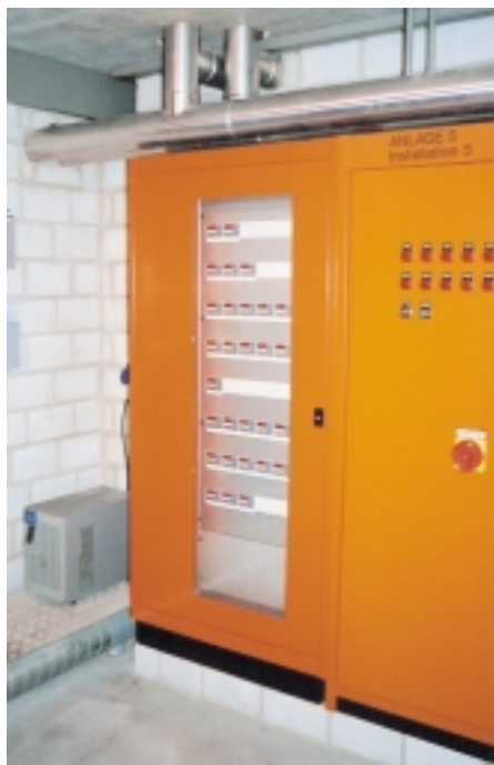
Alarmzentrale zur \text{NH}_3 -Überwachung
