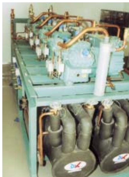
Kaltsolesatz 2 x 100 kW von compact, Soletemperatur -6/-12 °C, Antrifrogen N, mit jeweils 4 Bitzer Semihermetiks und einem Rohrbündelverdampfer von DK
