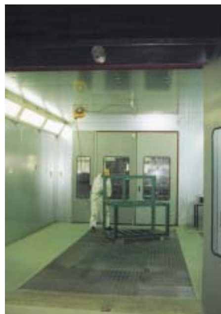
Auch die neue Lackieranlage mit Bodenabsaugung trägt zur verbesserten Farbqualität bei
