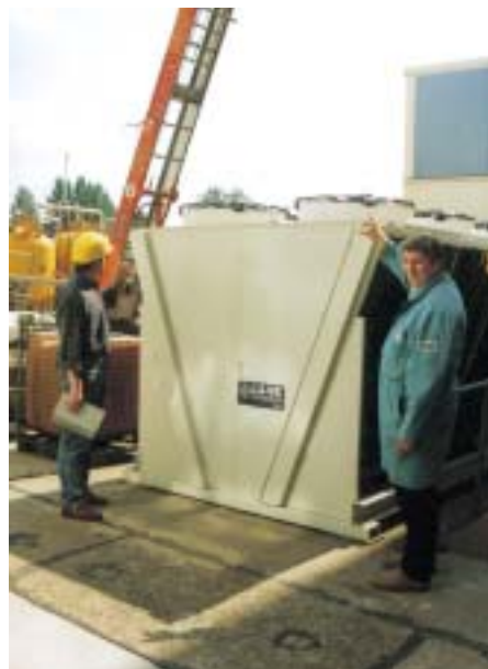
Auf das Dach des Degussa-Arzneimittelwerks in Radebeul muß er noch rauf; der luftgekühlte Axialverflüssiger in V-Bauart von LU-VE Contardo
