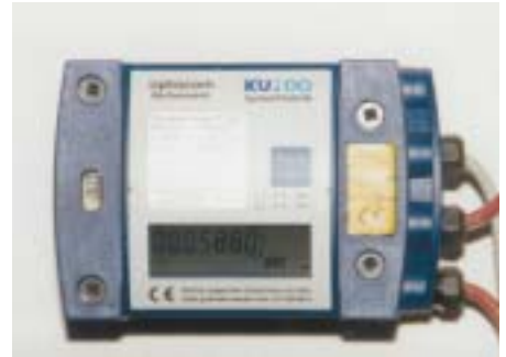
Im Technikraum befinden sich die Energiemengenähler für die zur Kälteerzeugung benötigte Energie . . .
