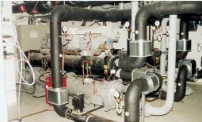
Zwei Aqua-Chiller von Carrier sorgen für die Bereitstellung von 2 \times 518 kW Kälteleistung
