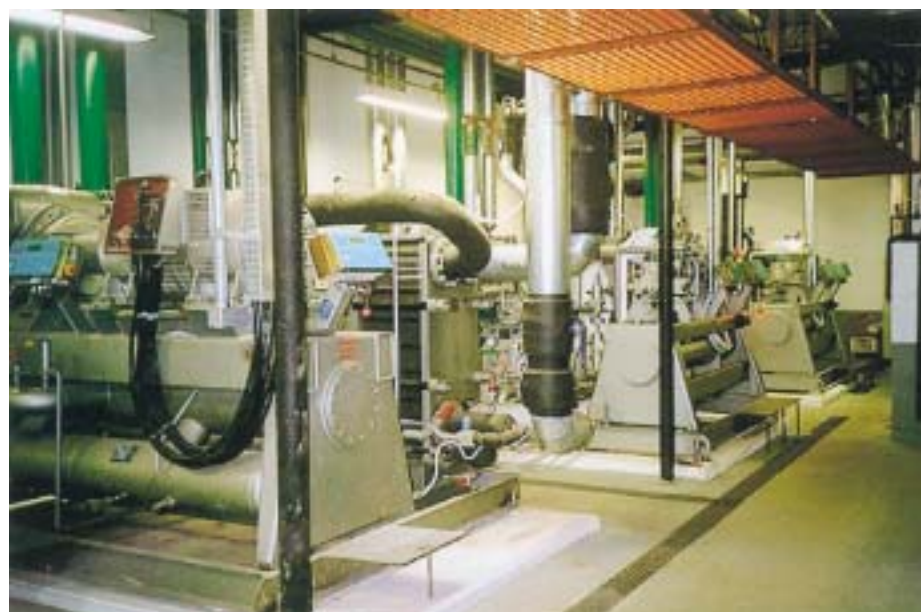
Bild 3 Zentrale Kälteanlage für Supermärkte bis 10 000 m 2 Verkaufsfläche. NH 2 -Flüssigkeitskältsätze mit Schraubenverdichtern für Kühlwasser/Klimaanlage, TYFOXIT® 1.20 und PG/Wasser (von links nach rechts)
