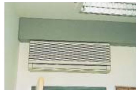
In den meisten Büros befinden sich mangels Zwischendecke allerdings Wandgeräte über den Türen, für deren Verrohrung ein Kanal harmonisch in den Räumen angebracht wurde, hier angedeutet über dem Gerät
