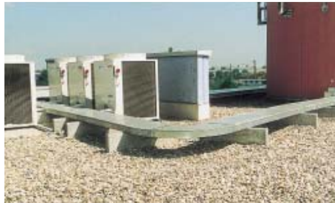
Sämtliche Leitungen führen über einen geschlossenen Kanal (zum Schutz für die Isolationen) von den 5 Außeneinheiten über den Versorgungsschacht (rosa im Hintergrund) zu den einzelnen Etagen
