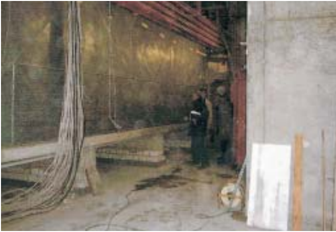
Ehemaliger Eiswasserspeicher mit einem Inhaltsvolumen von 210 m 3
