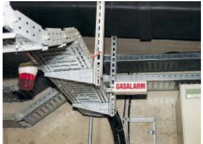
Teile der Warn- und Sicherheitskette zum Betrieb der NH 3 /Binäreis-Technik für die Klimaanlage im Landtag NRW
