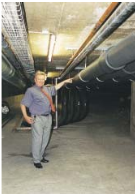
Der Binäreis-Transport im Talin-Corin-Wassergemisch erfolgt über ABS-Kunststoffleitungen mit Wärmedämmung gegen die Schwitzwasserbildung. Alle sehr komplizierten Rohrleitungsführungen wurden ebenfalls von Günter Schmidt bis ins letzte Detail geplant
