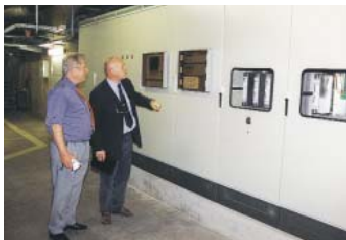
Hier werden die Signale der Binäreiszentrale an die Zentrale-Leit-Technik umgeformt und weitergeleitet. Objektleiter Thomas Kanthak (r.) vom Hauptauftragnehmer Hühren Kälte-Klima-Elektrotechnik und Günter Schmidt (l.), Planer für die Binäreistechnologie und Bauleiter, bei einer Überprüfung
