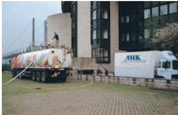
Der Binäreisspeicher wurde teilweise mit entkalktem Wasser vorgefüllt. Der Rest wurde mit dem Wärmeträgermedium Talin-Corin eingefüllt
