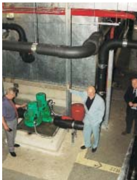
Über ein Volumen von 210 m 3 verfügt der Binäreispeicher (ehemaliger Eiswasserspeicher). Die Abbildung verdeutlicht die Proportionen: Im Vordergrund zwei der Pumpen für das Binäreis-Fluid
