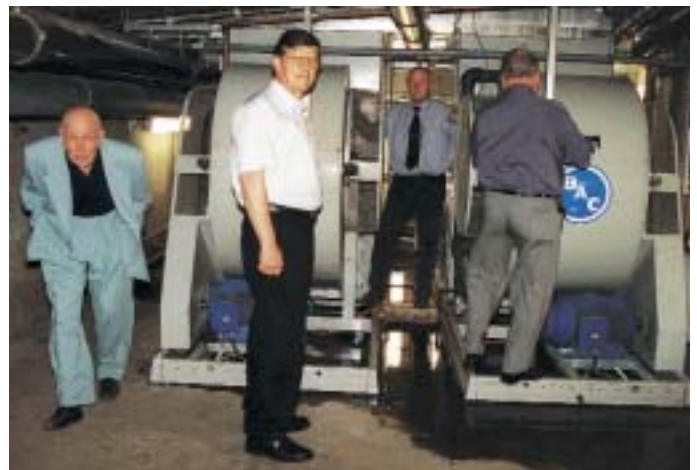
Die neuen Verdunstungskühler nach dem Zusammenbau und in Betrieb. In der Mitte MinR Rolf Lenk, Referatsleiter Hausverwaltung und Haustechnik
