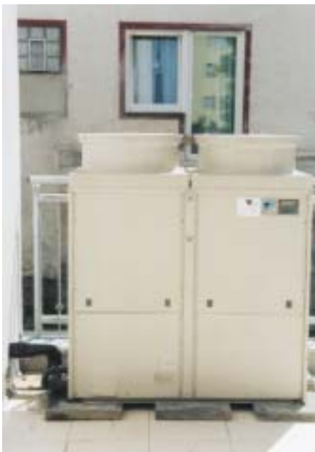
So einfach geht es. Platzsparende Aufstellung der VRV/VRF-Außeneinheit RSXP10K mit 31,5 kW/h Kälteleistung auf dem Balkon an der Rückseite des Gebäudes
