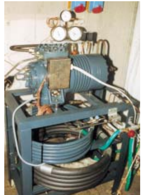
Hier ein 2stufiger CO 2 -Verdichter. Die erste Stufe arbeitet bei 67, die zweite Stufe bei 112 bar
