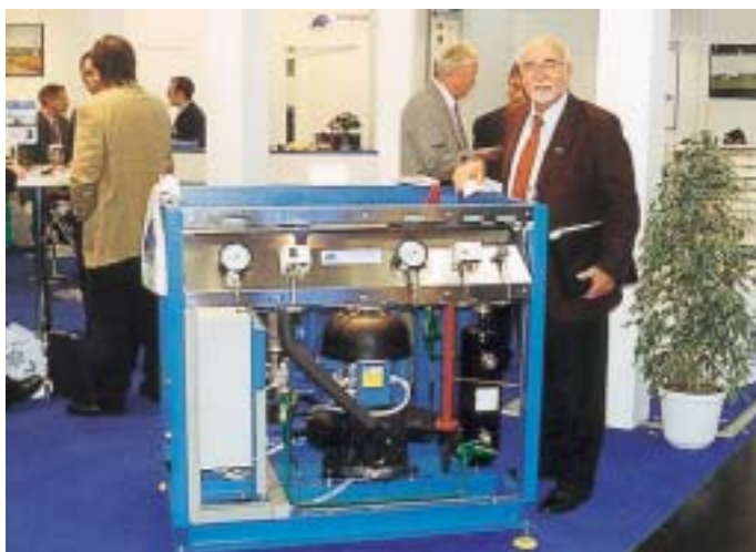
Frigopol-Kaltwassersatz mit Ammoniak auf der Basis eines Trennhauptverdichters
