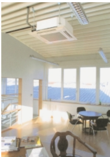
Bei der Systemtechnologie setzte der Architekt nicht auf altbewährte Heiztechnik, sondern ließ sich auf ein neues Wärmepumpensystem von Stulz ein – mit Erfolg, wie er heute weiß
