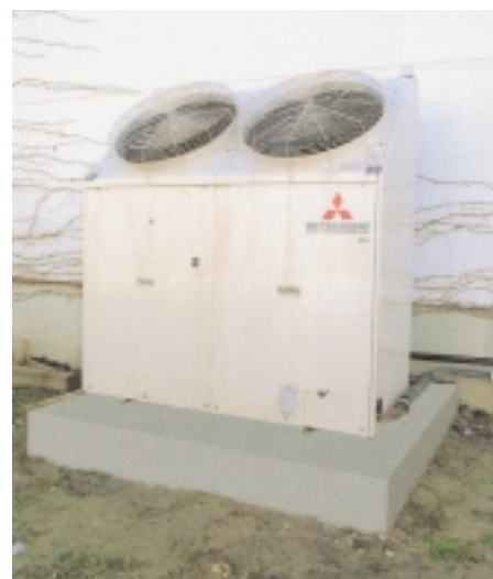
Die Außereinheit steht nicht auf dem Dach, sondern auf einem Sockel hinter dem Firmengebäude
