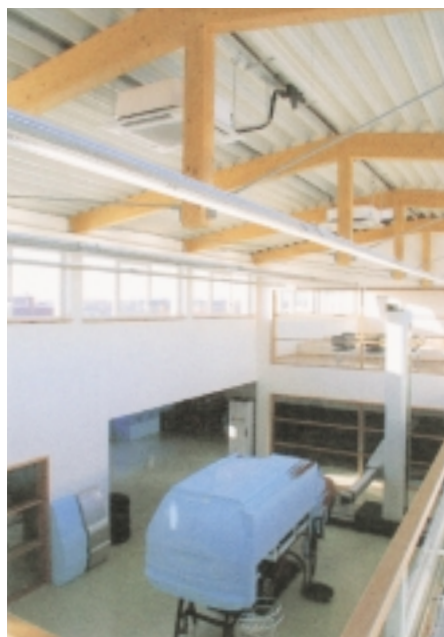
In der neuen Fertigungshalle mußten die Kassetten in großer Höhe installiert und die Leitungen auf Wunsch des Architekten Aufputz verlegt werden
