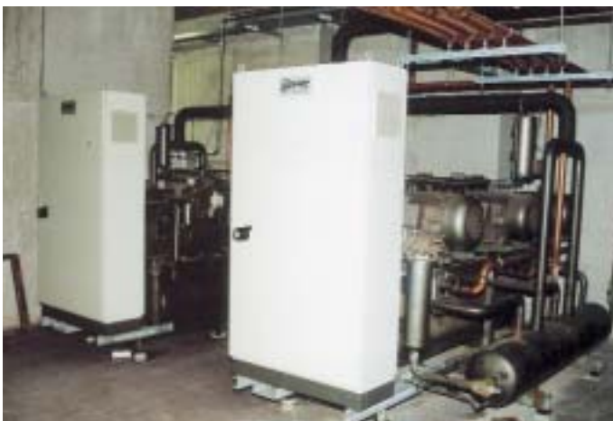
Teilansicht von drei Kältesätzen mit Bitzer-Hubkolbenverdichtern, Kälteleistung jeweils 56,8 \text{ kW} bei t_0 = 15 \text{ °C}/t_c = 45 \text{ °C} in der Weinkellerei Trautwein in Alzey. Auf dem Bild unten wird die Funktion eines überfluteten Röhrenkühlers für die Mostverköhlung von Gasser-Firmenchef Günter Löffler erklärt.
