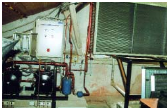
Innenaufstellung der dezentralen Verbundanlage (Fabrikat HKT-Goeldner) mit luftgekühltem Verflüssiger (Fabrikat Küba) im Dachbodenbereich des historischen Gasthauses „Blaue Gans“ in Salzburg
