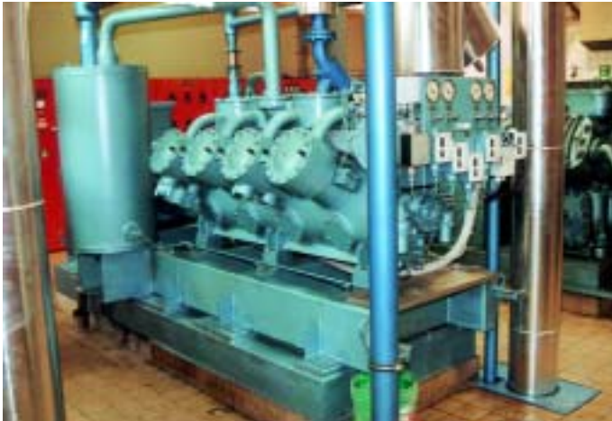
Bild 5 Grasso-Verdichter RC9312E im MUK-Kühlhaus Berlin-Neukölln
