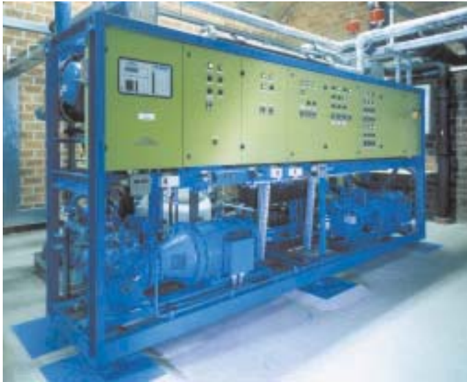
Bild 2 NH 3 -Solekühlanlage mit Hubkolbenverdichtern
