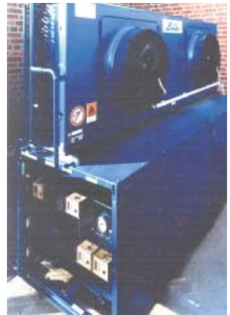
Bild 4 Im Freien aufgestellte luftgekühlte Propen-Kälteanlage für einen Discountmarkt
