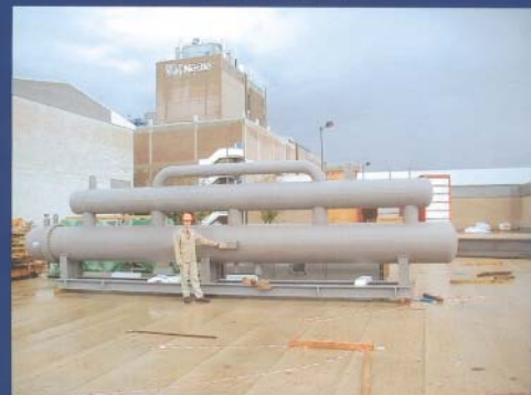
CO 2 /NH 3 -Kaskadenwärmeübertrager Vor Einbau
