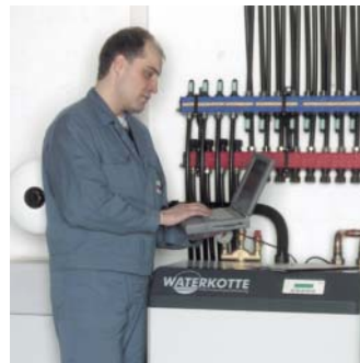
Wärmepumpen – Geschäftsfeld für Kälteanlagenbauer
