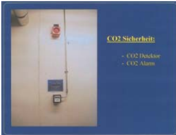
Bild 17 Beispiel für einen eingebauten CO 2 -Detektor mit Alarm
