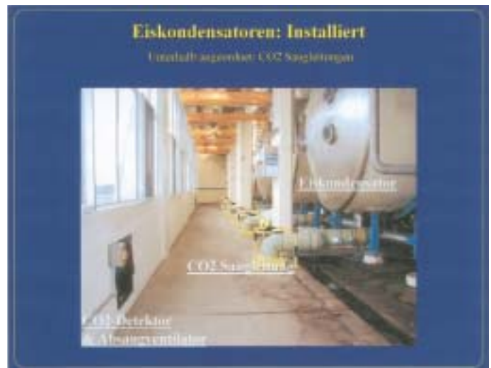
Bild 16 Gruppe installierter Eiskondensatoren
