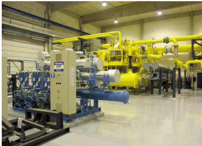
... sowie das System zur Luftverdichtung (gelb) bzw. die Kälteanlage zur Prozeßluftabkühlung (im Vordergrund) in der Maschinenhalle
