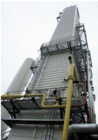
Die Rektifikationskolonne der Luftzerlegungsanlage ...
