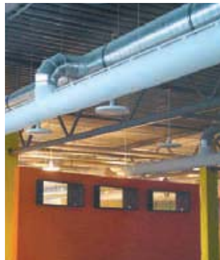
Luftkanäle unterschiedlicher Materialien sind zueinander kompatibel
