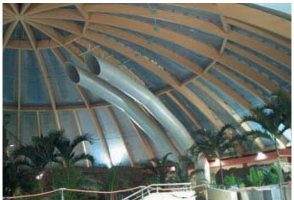
Die Firma Krug plant und installiert Lüftungs- und Klimasysteme. Das Unternehmen ist Spezialist für besondere Lösungen, wie hier in diesem Freizeitbad in Dorsten
