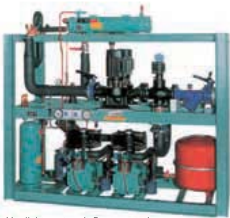
Verdichtersatz mit Pumpenstation für die Tiefkühlung mit R 404A und 7,8 kW bei -35/+45 °C
