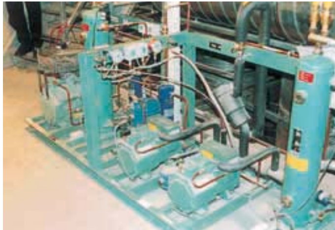
Verdichtersatz im Einbauzustand in beengten Raumverhältnissen
