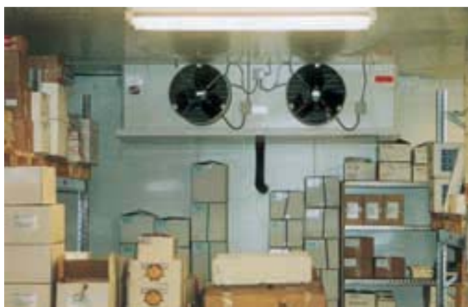
Luftkühler im TK-Raum mit Heißgas-Abtauung
