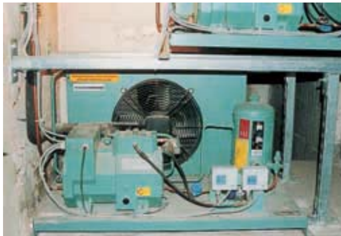
Verdichtersätze für die Kühlung der Hummerbecken. Man sieht den zweiten versetzt über dem ersten angeordnet, den geringen Einbauraum berücksichtigend
