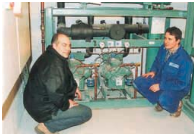
Projektleiter Manfred Tolle und Servicemeister Andreas Borst (beide Dresdner Kühlanlagenbau) überprüfen die Funktion eines Verdichtersatzes
