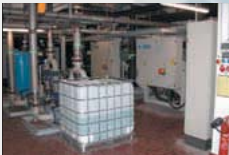
Die neue Klima-Zentrale
