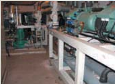
Blick in den Maschinenraum
