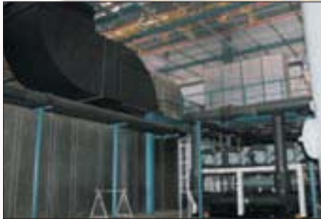
Luftaufbereitungszentrale und ein Teil des Kaltwassersatzes
