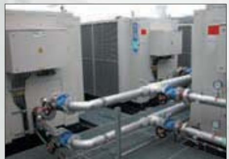
Rohrleitungen wurden komplett in Edelstahl ausgeführt
