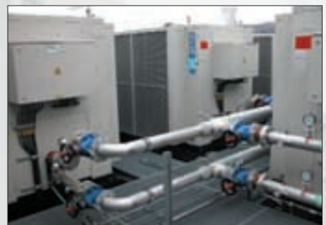
Rohrleitungen wurden komplett in Edelstahl ausgeführt
