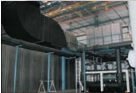
Luftaufbereitungszentrale und ein Teil des Kaltwassersatzes
