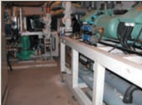
Blick in den Maschinenraum
