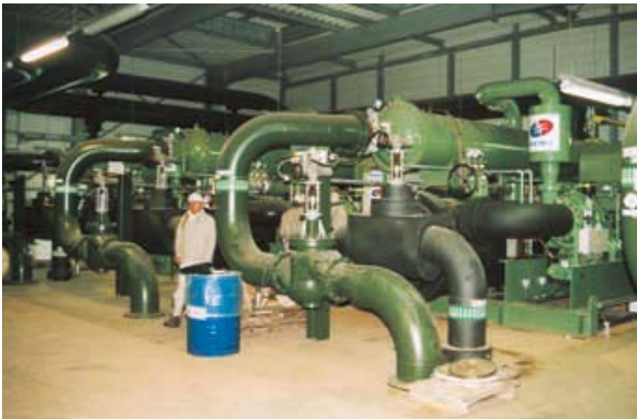
Größenvergleich. Das ist doch gigantisch. 4 Axima Turbokältemaschinen Typ Unitop 33CX mit jeweils 5 MW Kälteleistung hintereinander ...
