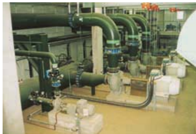
... im Raum daneben ein Teil der Kaltwasserförder- und Rücklaufpumpen
