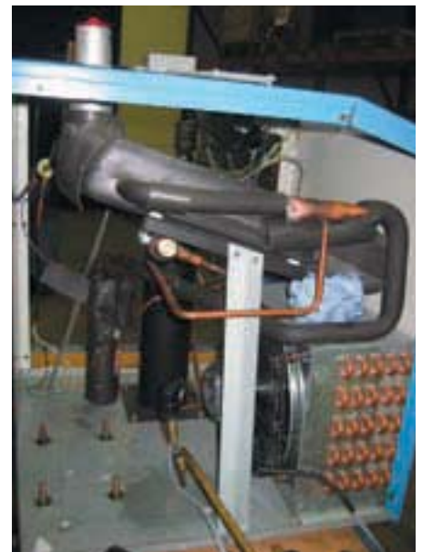
Bild 1 Drucklufttrockner ohne beschädigtem Verdichter vor dem Spülen
