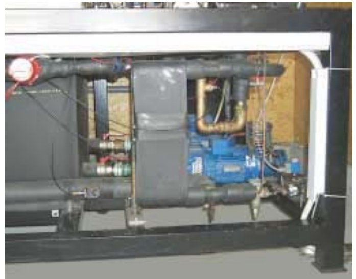
Bild 5 Verdampfer und Expansionsventil, dahinter die Pumpen für die Wasserkreise
