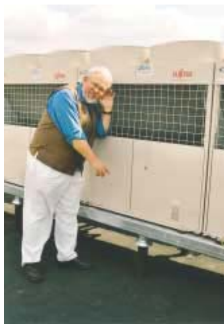
„Ich höre nichts“, verdeutlicht Kälteanlagenbauermeister Hermann Stibbe lachend dem Fotografen, allerdings war am 12. Mai 2003 um 11:45 Uhr auch nur eine der vier Außeneinheiten in Betrieb
