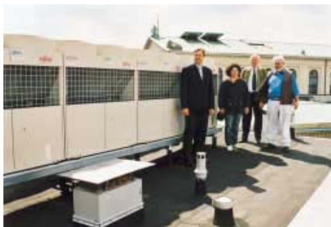
Nach einmonatigem Klimabetrieb zeigt sich Hoteldirektor Michael Rupp (l.) mit der Kaufentscheidung pro VRF-System von AxAir zufrieden. Übrigens stehen die Außeneinheiten auf unterschiedlich hohen „Stelzen“; auch um das Dachgefälle auszugleichen. Direkt dahinter ein Teil der Dachansicht von Hannovers Oper
