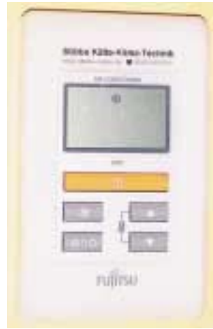
Hinter dem kaschierten Deckensturz mit Ansaug- und Ausblagittern verbirgt sich das Zwischendecken-gerät mit ca. 2 kW Kühlleistung. Die Raumtemperatur und die Lüfterfunktionen kann der Gast oberhalb des Lichtschalters über eine im Mauerwerk integrierte Kabelfernbedienung einschalten und kontrollieren
