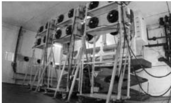
Bild 4 Luftkühlerprüfstand entsprechend DIN EN 328-Bedingungen mit Entfeuchtungskühlern im Vordergrund, dahinter dem zu prüfenden NH 3 -Luftkühler und der elektrischen Gegenheizung an der Wand
