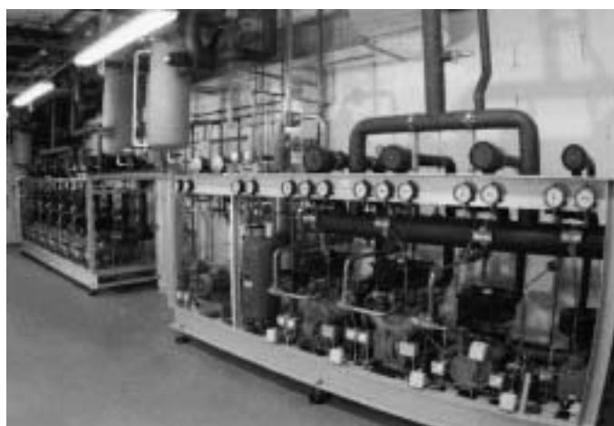
Bild 6 Maschinenraum für die Kältemittel R 404A und R 507
