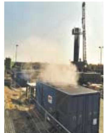
Mietkühltürme EWK-D 930 MC von Axima
