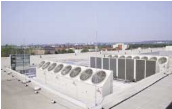
Die 27 Außengeräte des Multisplitsystems befinden sich abgesenkt auf dem Dach des Gebäudes. Sie haben jeweils eine Kühlleistung von 28 kW und eine Heizleistung von 32 kW
