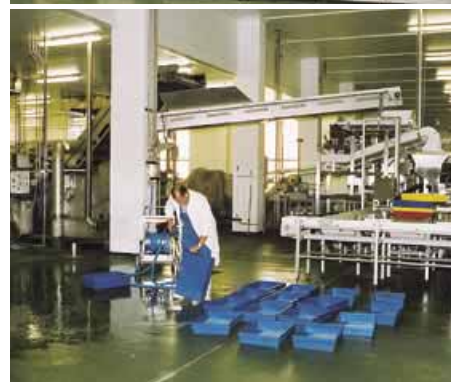
Alle Bearbeitungsräume werden durch unterschiedliche Luftkühler auf mindestens +18 °C temperiert. Dort, wo mit aggressiven Medien bei der Marinierung gearbeitet wird, sind Rohre und Gehäuse aus Edelstahl, die Lamellen goldlackbeschichtet
