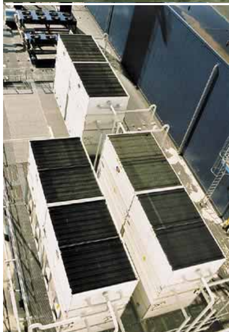
3 Verdunstungsverflüssiger auf einem Vordach, Verflüssigerleistung jeweils 2200 kW
