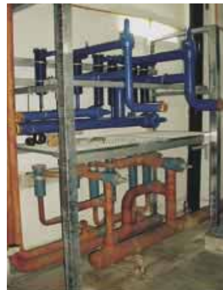
Filtertrocknerstation, alt (unten) und neu (oben) nach Sanierung der Kältemittelkreisläufe durch P & P
