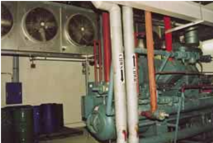
Einige „enteiste“ BOHN-Verdampfer konnten im Rahmen der Umbau- maßnahmen für die Klimatisierung des Maschinenraumes zweckdienlich verwendet werden
