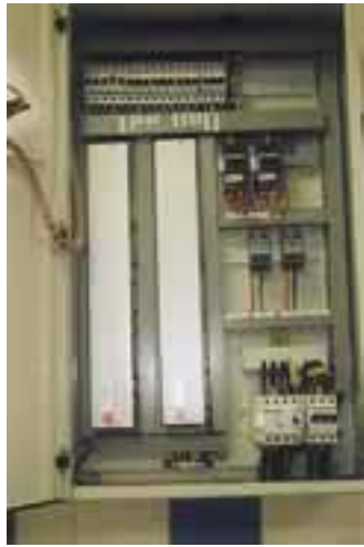
Elektrische Verdrahtung in den Schalt-schränken, „vorher“ und „hinterher“ durch Prause & Partner
