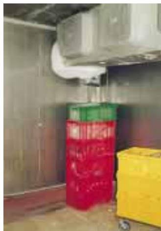
Kein Einzelfall: Vereisende/verdampfende Flüssigkeitsleitungen vor dem E-Ventil an den BOHN-Verdampfern; fotografiert am 14. 7. 1999
