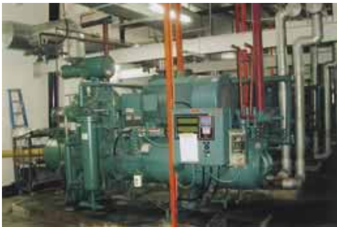
Zur Kälteversorgung aller Kühl- und Tiefkühlstellen wurden für die beiden Temperaturkreisläufe je zwei Schraubenverdichteraggregate des Fabrikats FRICK sowie ein fünftes Schraubenverdichteraggregat als Stand-by-Maschine installiert
