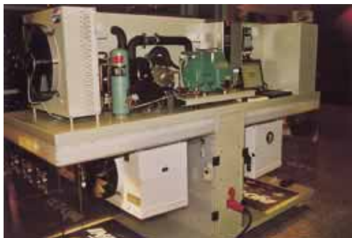
Demonstrations-Kälteanlage mit frequenzgeregelten Halbhermetiks in einem 4er-Verbund mit modernster Verbundelektronik und elektronischem Expansionsventil, einem drehzahleregelten Verflüssiger und...
